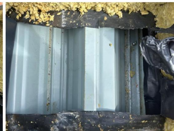
Foto Nr. 164 Atsegums Nr.3. Kondensāts uz nesošā profilklāja.
